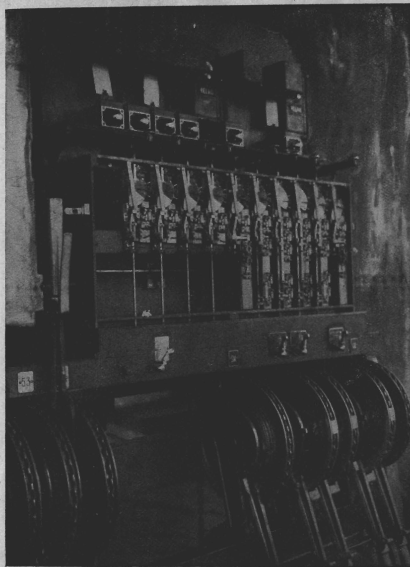
APPARATO CENTRALE Tipo S. B. W.
