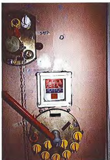
Seccionador SMTP (Pantógrafos) Seccionador SMT (C. Alta)
